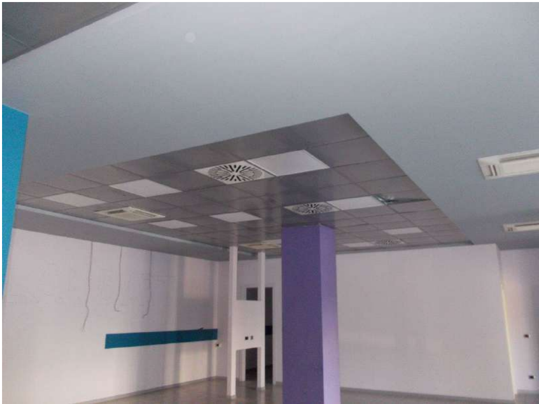
Foto 7. Climatizzazione e ventilazione meccanica a soffitto
